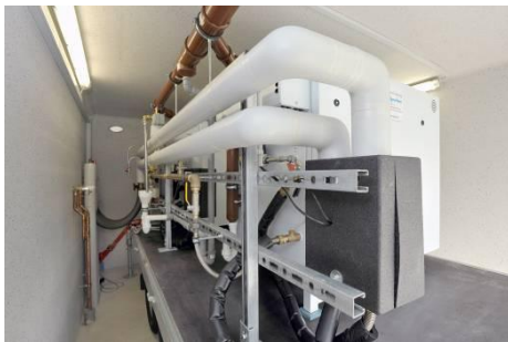
Bild 4: Neben den beiden BHKW befindet sich auf dem Tandemanhänger die gesamte Verrohrung der Anlage sowie die Station einschließlich der Anschlüsse für Gas, Abgas, Vor- und Rücklauf sowie Elektrizität.
