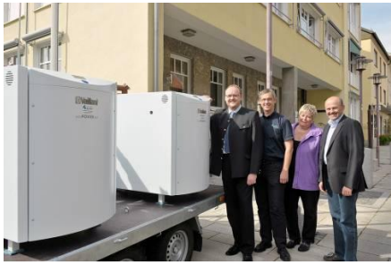
Bild 3: Die Beteiligten sind sich einig – mit der mobilen KWK-Anlage lassen sich sowohl die Energiekosten als auch der CO 2 -Ausstoß deutlich reduzieren. Von links: Andreas Meier, Bürgermeister, Christian Sperber, Geschäftsführer von Bad & Heizung Sperber, Aurelia Zimmermann, Vorsitzende des Fördervereins, Thomas Wilhelm, Stadtrat.
